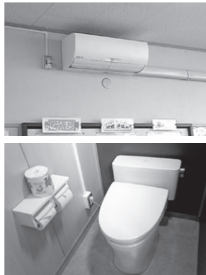
設置改修された小・中学校のエアコン、トイレ
