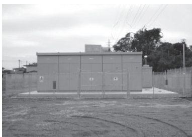
蓄電池設備（上）と変電所（下）
