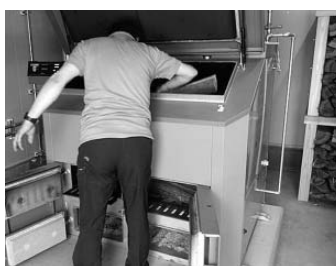
道の駅ふたついに導入されたまきボイラー
