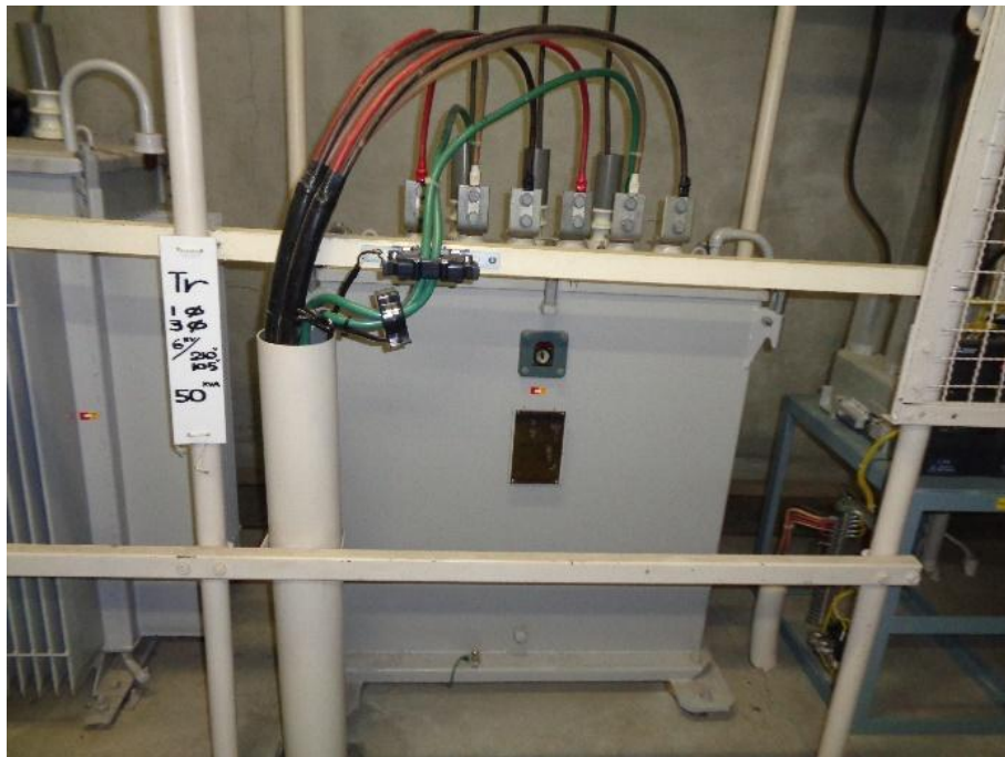
②非常電灯変圧器 50KVA 395340 ON-AN 東芝電機 1979
