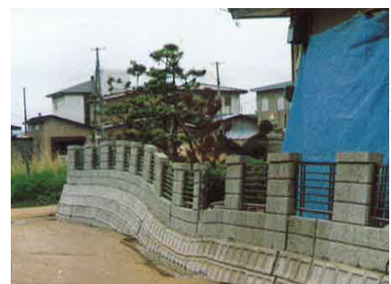
陥没し、波打つブロック壁（大須賀団地）
