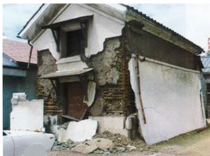
壁が落ちた土蔵（市役所）
