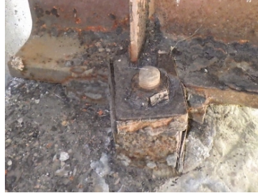
支承の機能障害
