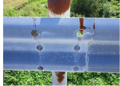
防護柵のボルトの脱落
