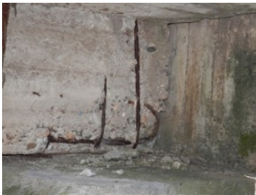
主桁の鉄筋露出
