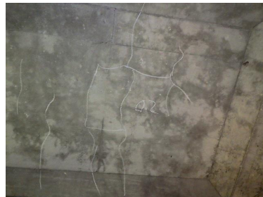
床版のひびわれ
