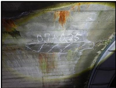
コンクリートのうき (前回点検から 進行は認められない。)
