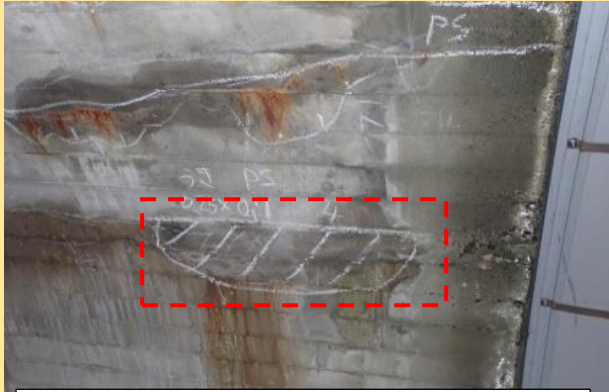
①トンネル内壁のコンクリート表面が劣化して浮き上がっている箇所。監視する。
