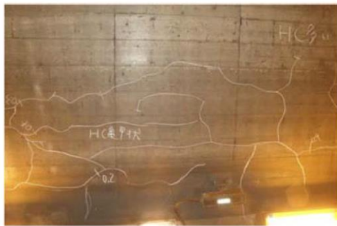
ひび割れの例
