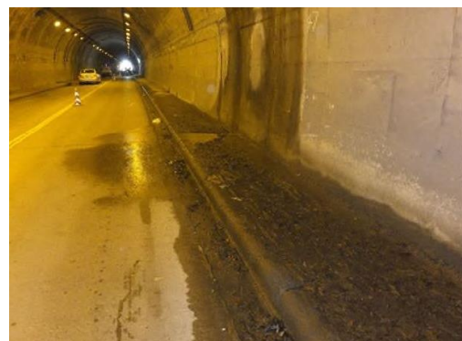
漏水の例(2)路面に滞水
