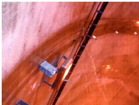
漏水の例(1)天井から吹き出し
