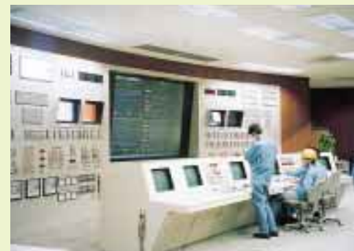
火力発電所・中央制御室
