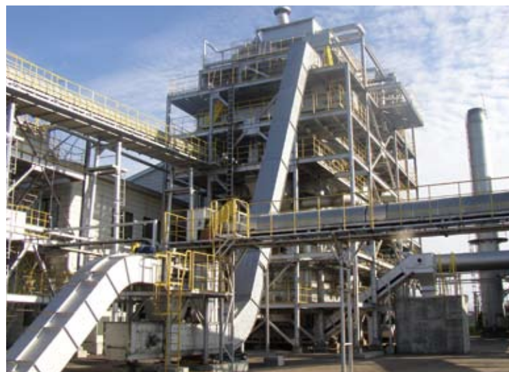
能代バイオマス発電所
